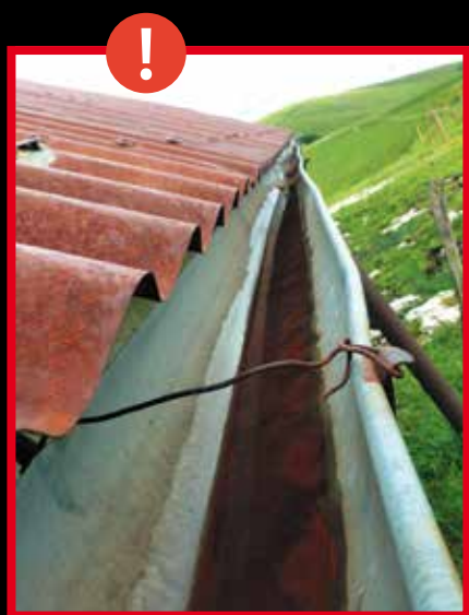
1. Necessario verificare l'integrità del tetto e delle grondaie
