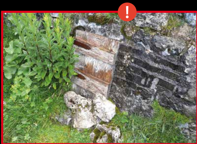
2. Necessario mettere in sicurezza la sorgente
