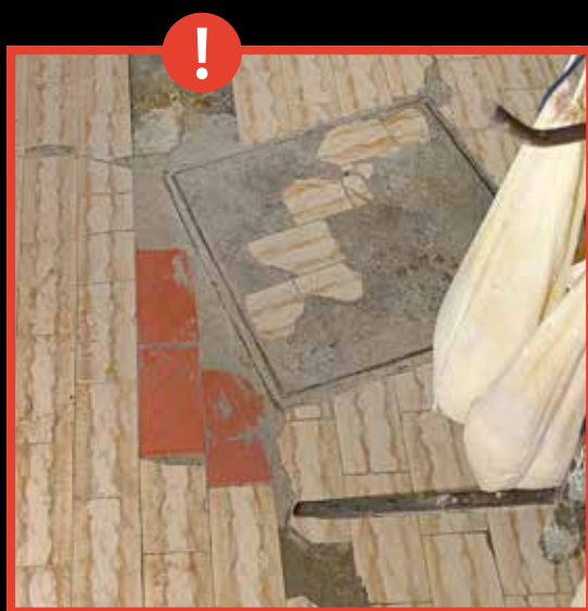
2. Pavimentazione da sistemare
