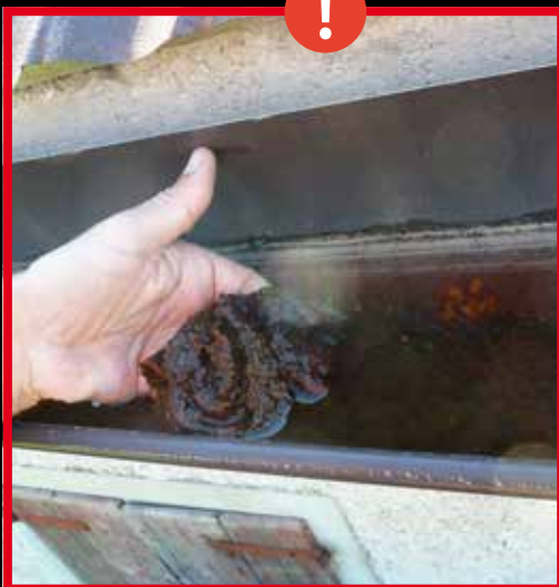
3. Grondaia con ristagno di acqua causata da pendenza non corretta
