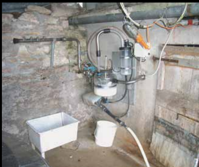
13. Verificare periodicamente parti meccaniche della pompa del vuoto e la pressione erogata
